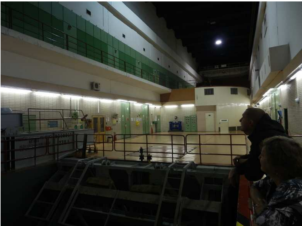
Ve strojovně (kaverně)– 160 metrů pod hladinou jezera
