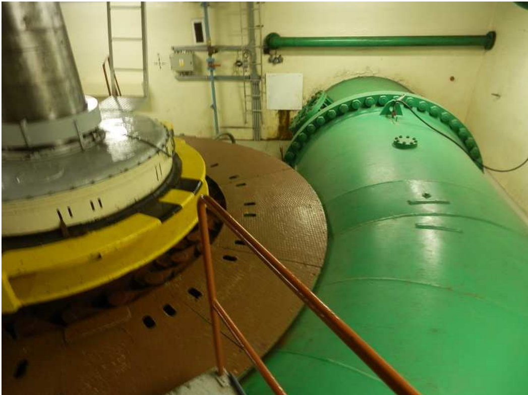
Přívod vody k turbínám
